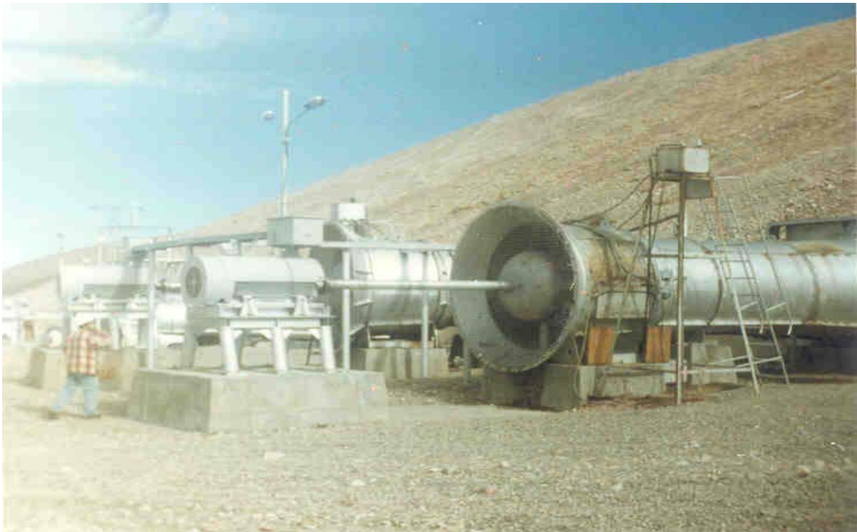
VENTILADORES MINA EL SALVADOR
